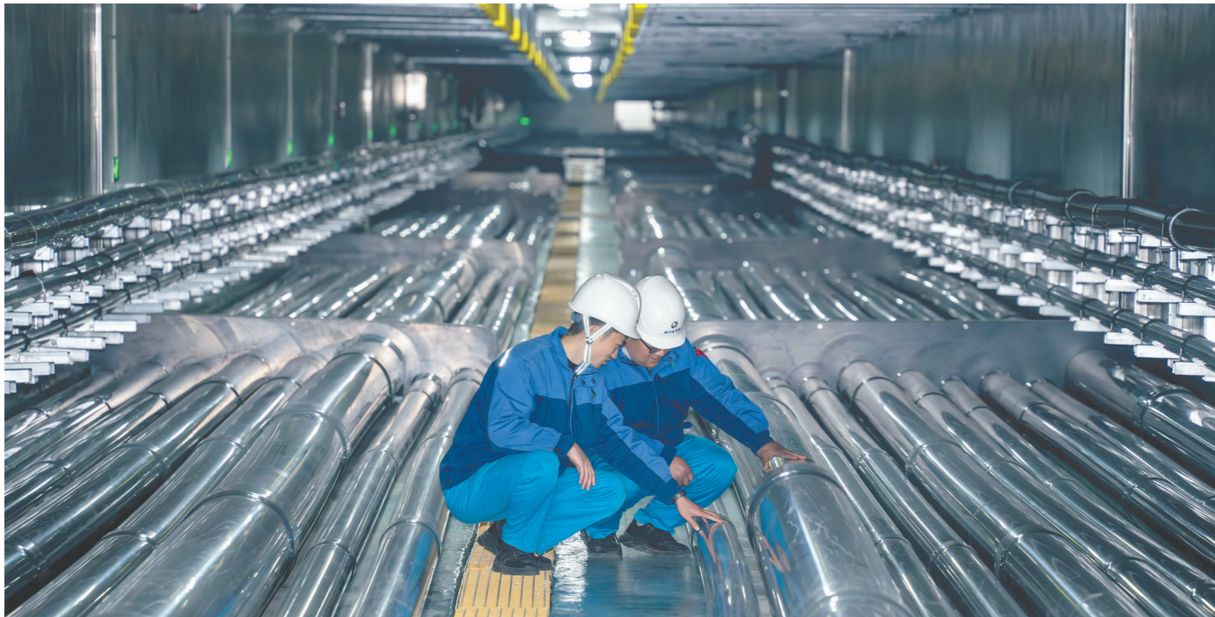
园区工作人员检查地下综合管廊内的管道。
